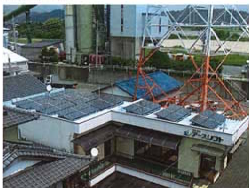
本社ソーラーパネルシステム
