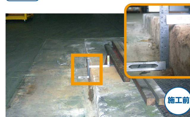
茨城県の工場。300tあるプレス機の基礎部分と周囲のコンクリート土間床に段差が生じていました。この危険な段差の解消が第一の目的でした。
