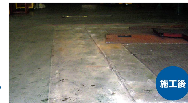
実質2日間の工事でおおよそ90mmあった段差を解消し、他エリアのコンクリート土間床のたわみも軽減しました。
