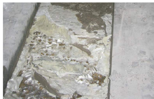
隙間を充填後の床下状況 ※コンクリート床を一部はがして撮影
